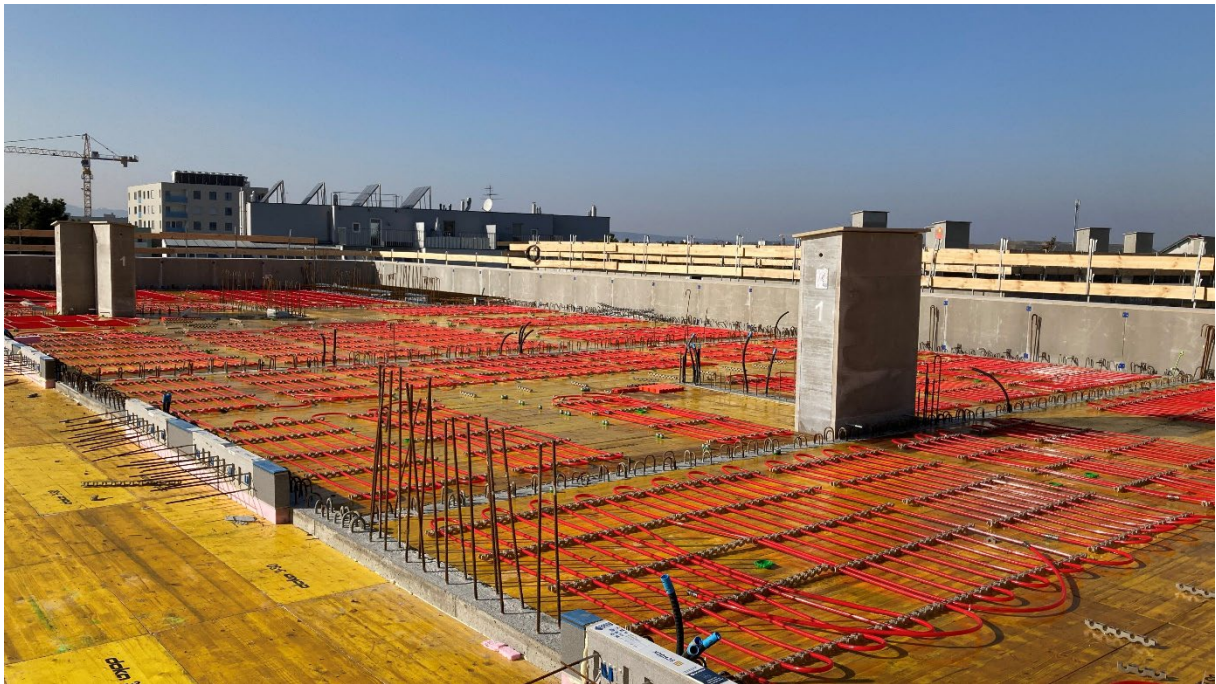
Bauteilaktivierung (rote Leitungen)
